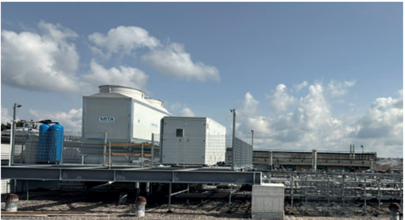
La centrale frigorifera a servizio della nuova linea di surgelazione: una piattaforma industriale progettata per funzionamento continuo.
